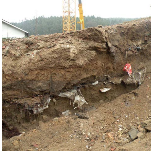
Abbildung 6: Verunreinigtes Erdreich im Baulos 4.1
